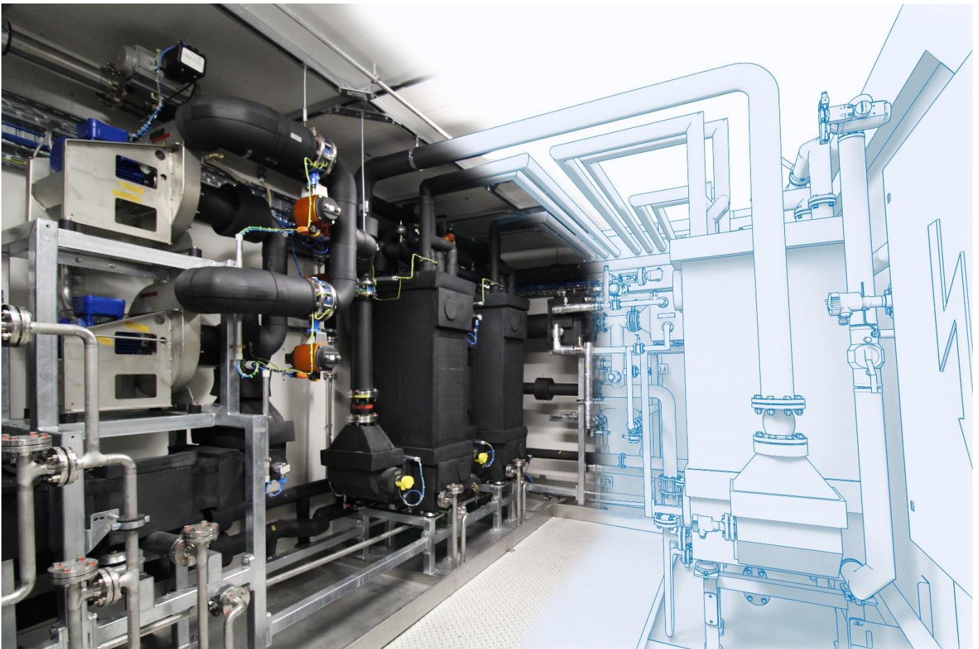
Abbildung: Abluftreinigungsanlage mit Lösemittelrückgewinnung nach Pharma-Standards
