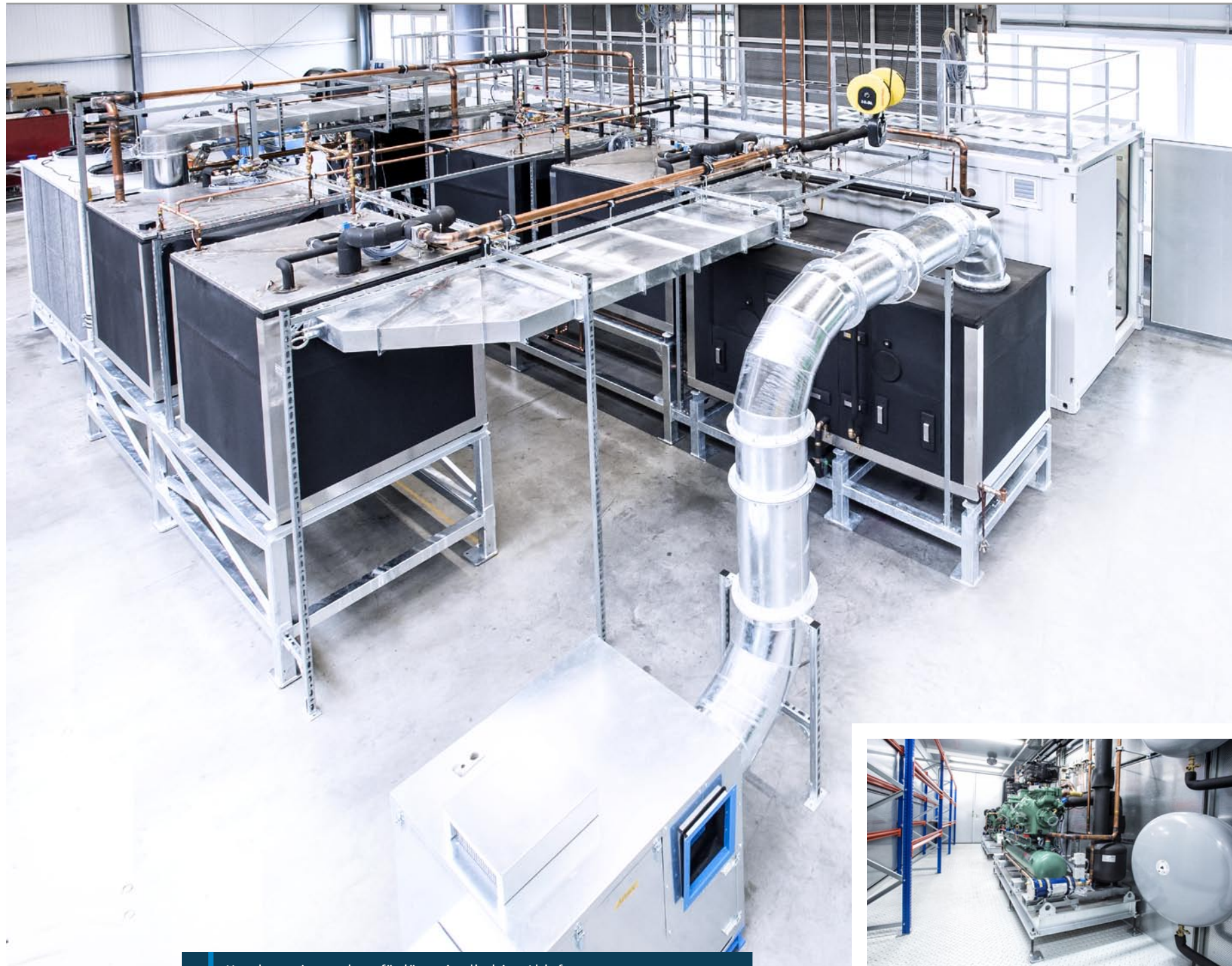
Kondensationsanlage für lösemittelhaltige Abluft
