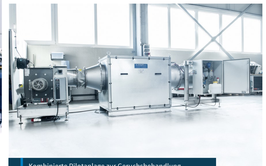
Kombinierte Pilotanlage zur Geruchsbehandlung
